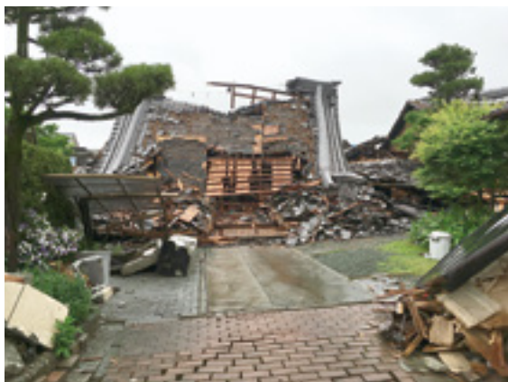
倒壊した家屋の様子
